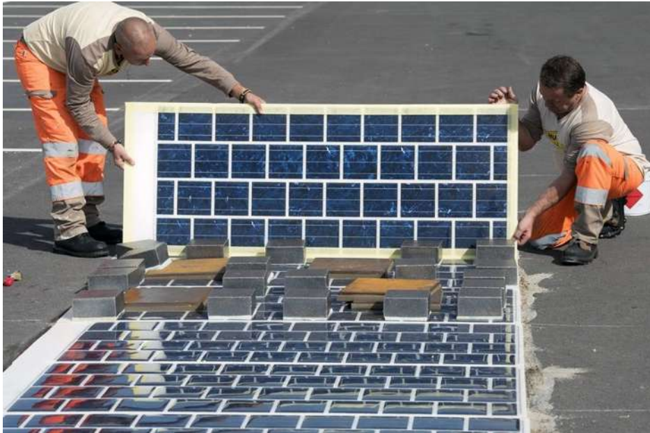
Рис. 3. Ділянка автомобільної дороги, вкрита сонячними батареями
