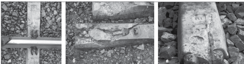
Рис. 3. Характерні пошкодження залізобетонних шпал зі скріпленнями з високою поперечною жорсткістю — подовжні тріщини від анкера до торця шпали: а, б — шпали СБЗ-1 зі скріпленням КПП-5; в — шпали зі скріпленням Vossloh W 14 (Литовська залізниця)
