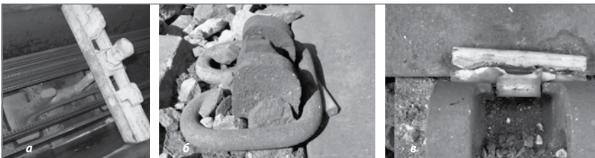
Рис. 4. Анкерне скріплення з високою поперечною жорсткістю APC-4: а — деталь зі з'єднаних скобою анкерів, зафіксована у формі перед формуванням шпал (Белгородський ЗЗБШ, Росія); б, в — характерні пошкодження — руйнування полімерних вкладишів на ділянці Іларіоново – Синельникове Придніпровської залізниці
