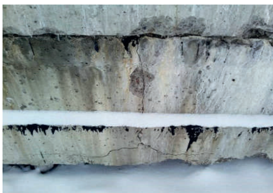
Рисунок 10 — Балка №7. Вертикальна тріщина посередині прогону
