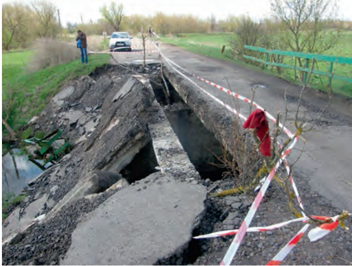
Рисунок 12 — Міст на а/д Т-04-23 км 17+750 (Дніпропетровська область). У результаті підмиву паводком ґрунтових фундаментів зруйнувалися проміжні опори (2015 рік)
