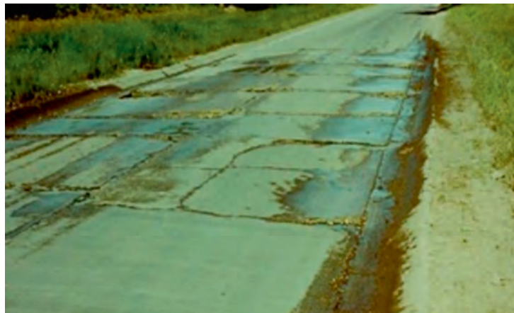
Рисунок 4 — Виплескування перезволоженого ґрунту з-під плити
