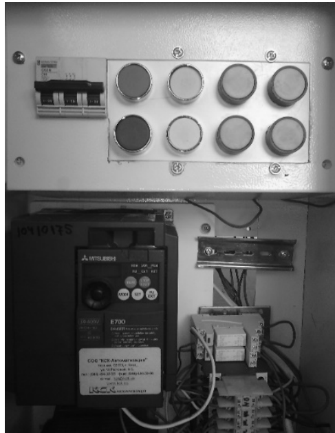
Рисунок 5 – Електрошафа з частотним перетворювачем Mitsubishi FR-E740-060
