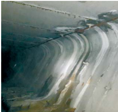
Рис. 5. Просочування води у залізобетонних прогонових будовах
