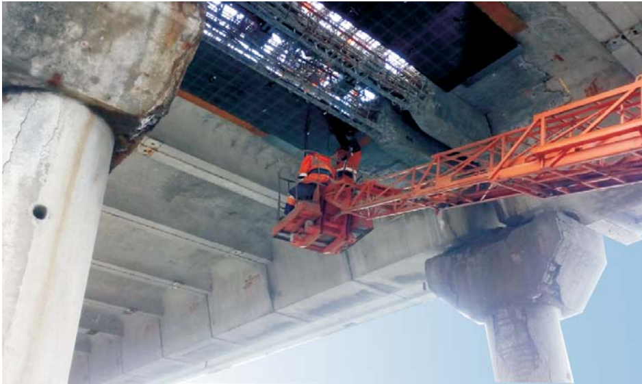
Рис. 4. Руйнування бетону в місцях влаштування деформаційних швів
