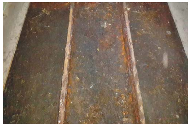
Рис. 8. Корозія металу в сталевих прогонових будовах
