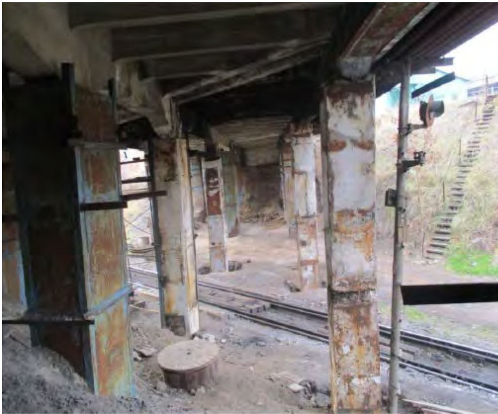
Рис. 3. Загальний стан конструкцій шляхопроводу
