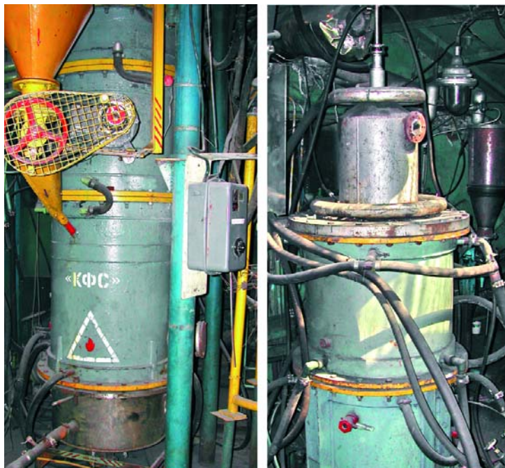
Рис. 7. Устройство управления механизмами встряхивания электродов электрофильтров
