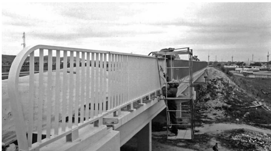
Нанесение антикоррозийного покрытия на металлические элементы мостовых конструкций по технологиям, разработанным в ФМИ
