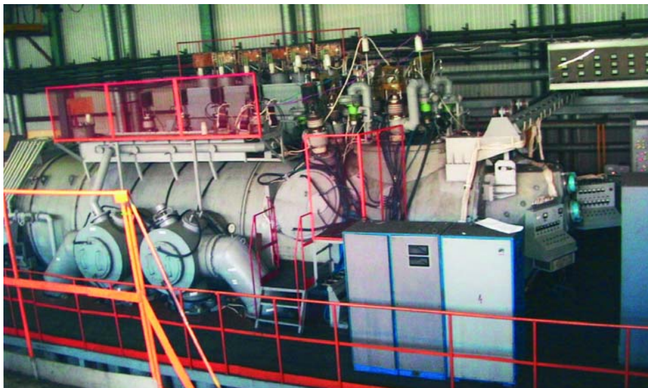
Установка для электронно-лучевой переплавки титана на ОЗСЭМ Института электросварки им. Е.О. Патона НАН Украины
