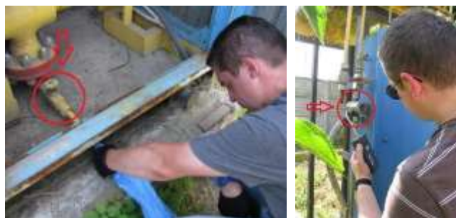
Рис. 13. Виявлення нетехнологічного витоку природного газу на елементах обладнання АГНКС: а) дренаж замірного вузла; б) індикаторний пристрій одоризації газу.
